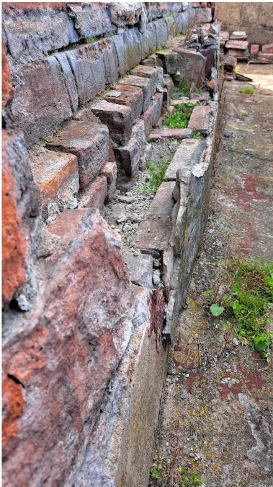
Rozpadlá konstrukce soklu zdiva helmice jehlanu. Havarijní stav.
