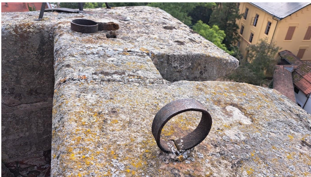
Uvolněné kovové prvky z pískovcových prvků. Uvolněné, vydrolené spáry. Rozšiřující – se praskliny ve spárách cimbuří ochozu věže.
