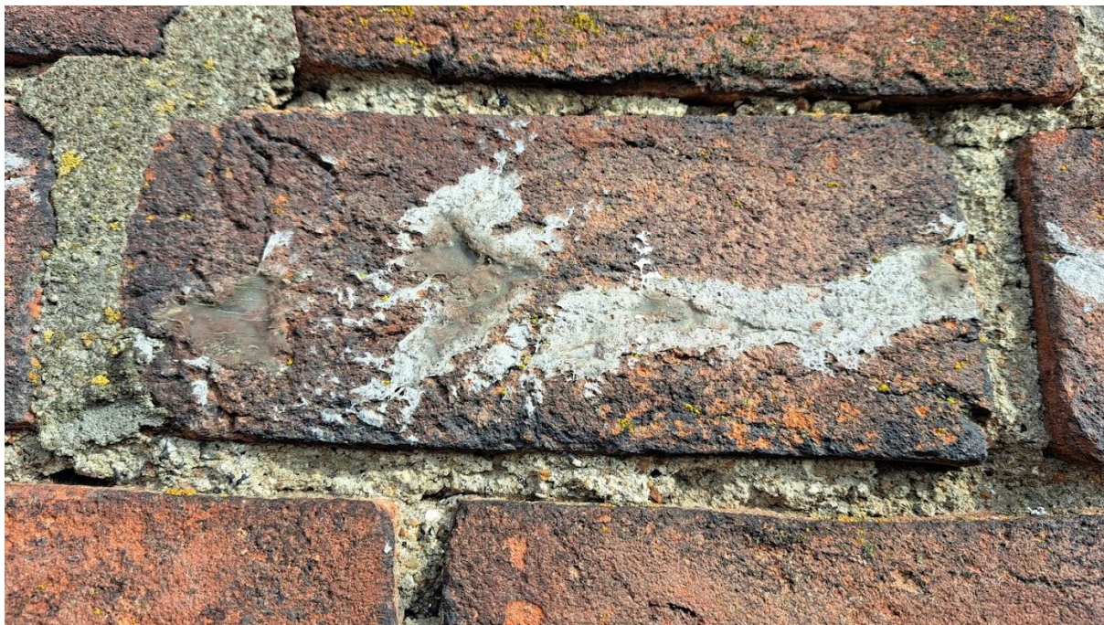
Nevhodné vysprávky cihel silikonem.
