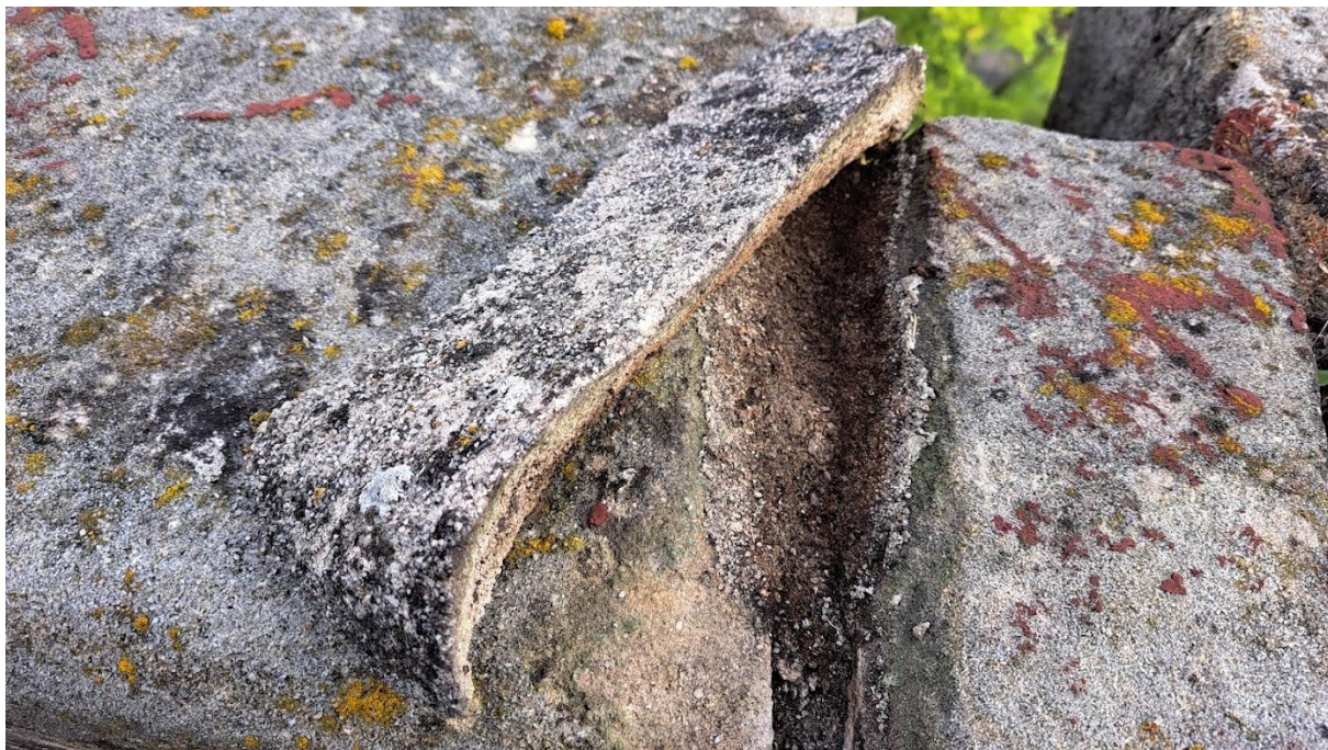
Uvolněné, vydrolené spáry. Rozšiřující – se praskliny ve spárách cimbuří ochozu věže.
